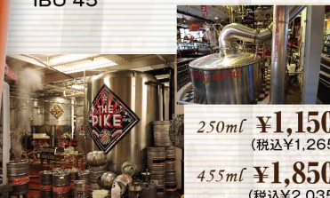
パイク店舗内に設置された醸造タンク
